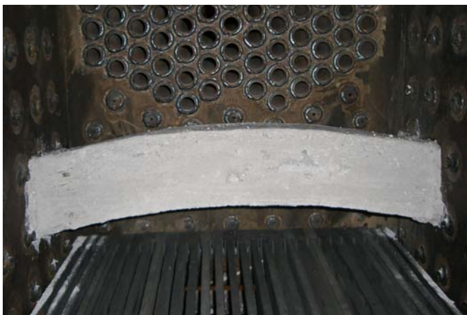
Der Feuerschirm und die Rostlage sind in der Feuerbüchse eingebaut.
